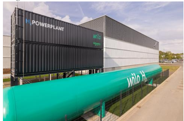
Fig. 1: Projeto piloto do H2POWERPLANT, instalado na principal planta de produção da Wilo em Dortmund, Alemanha
