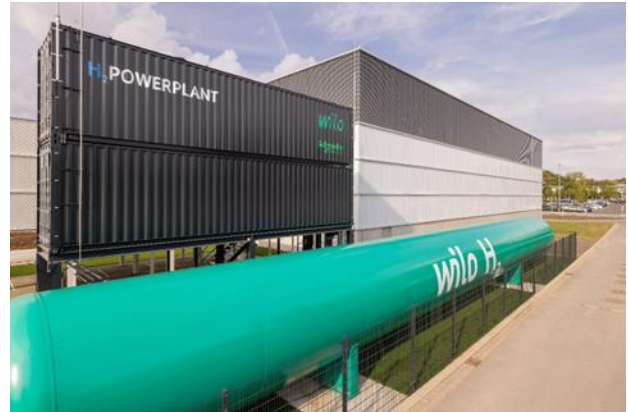
Fig. 1: Proyecto piloto de la H2POWERPLANT, instalada en la planta de producción principal de Wilo en Dortmund, Alemania.
