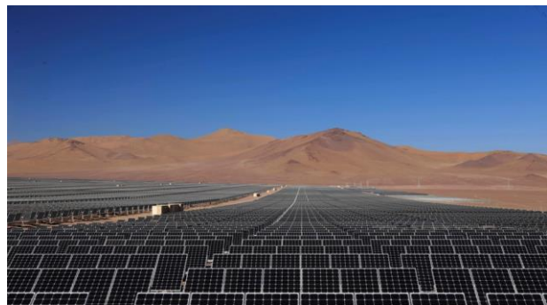
Parque fotovoltaico en la región de Antofagasta © Acera AG
