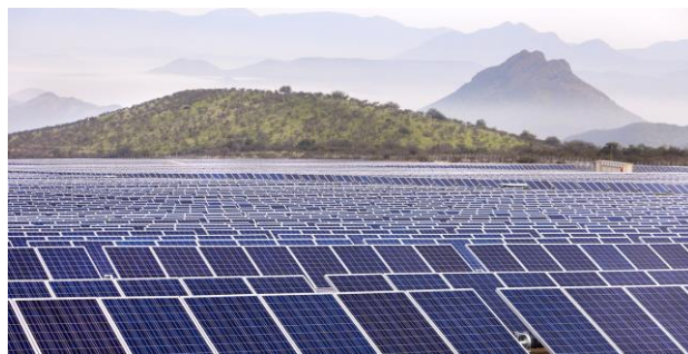
Abbildung 1: Solaranlage in Chile Zentral
