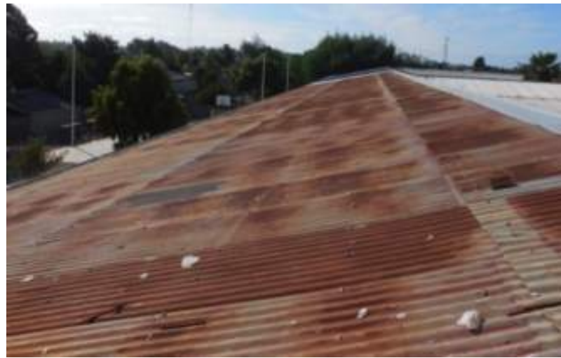
Ilustración 16 Techumbre oxidada (Fuente: Ministerio de Energía)
