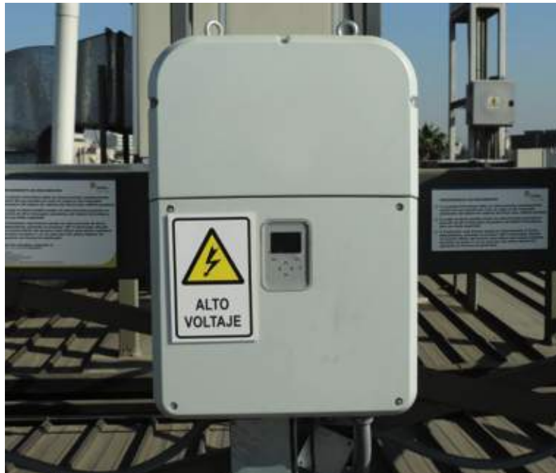
Ilustración 4 Inversor de 33 kW (Fuente: Ministerio de Energía)
