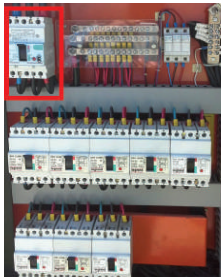
Ilustración 23 Tablero general de un establecimiento. (Fuente: Ministerio de Energía)
