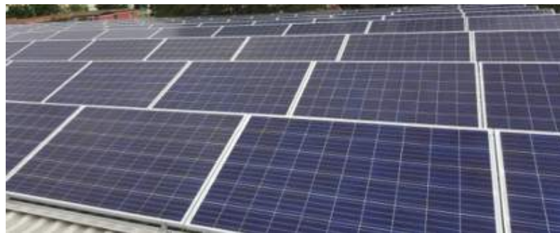
Ilustración 3 Ejemplo módulos en un sistema FV, Teletón Santiago (Fuente: Ministerio de Energía)
