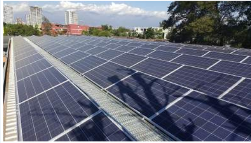
Ilustración 19 Sistema FV con sombra externa, producida por un árbol cercano al edificio (Fuente: Ministerio de Energía)
