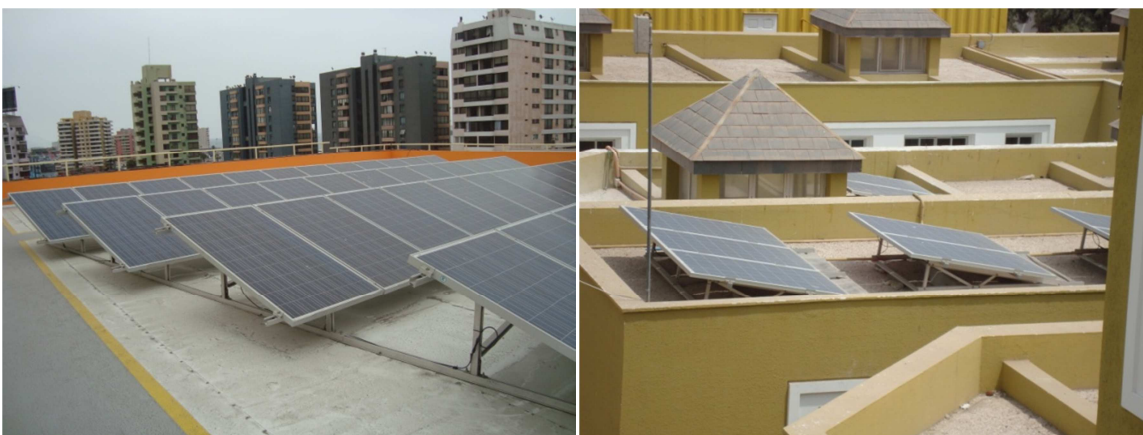
Ilustración 4: Algunas de las instalaciones FV en la UA
