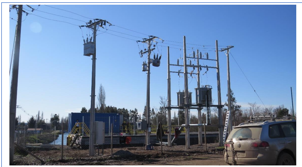
Figura 4-7: Fotografía sistema de conexión a la red de un PMGD Fuente: Gentileza Sr. Francisco Beltrán Jara
