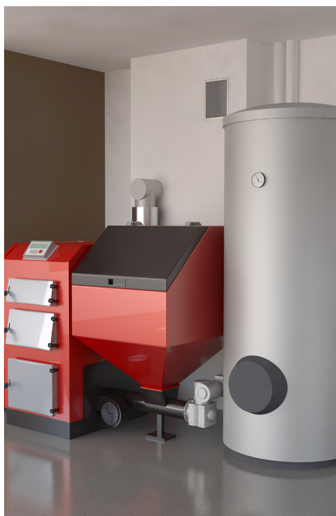
Caldera de biomasa para agua caliente sanitaria.
